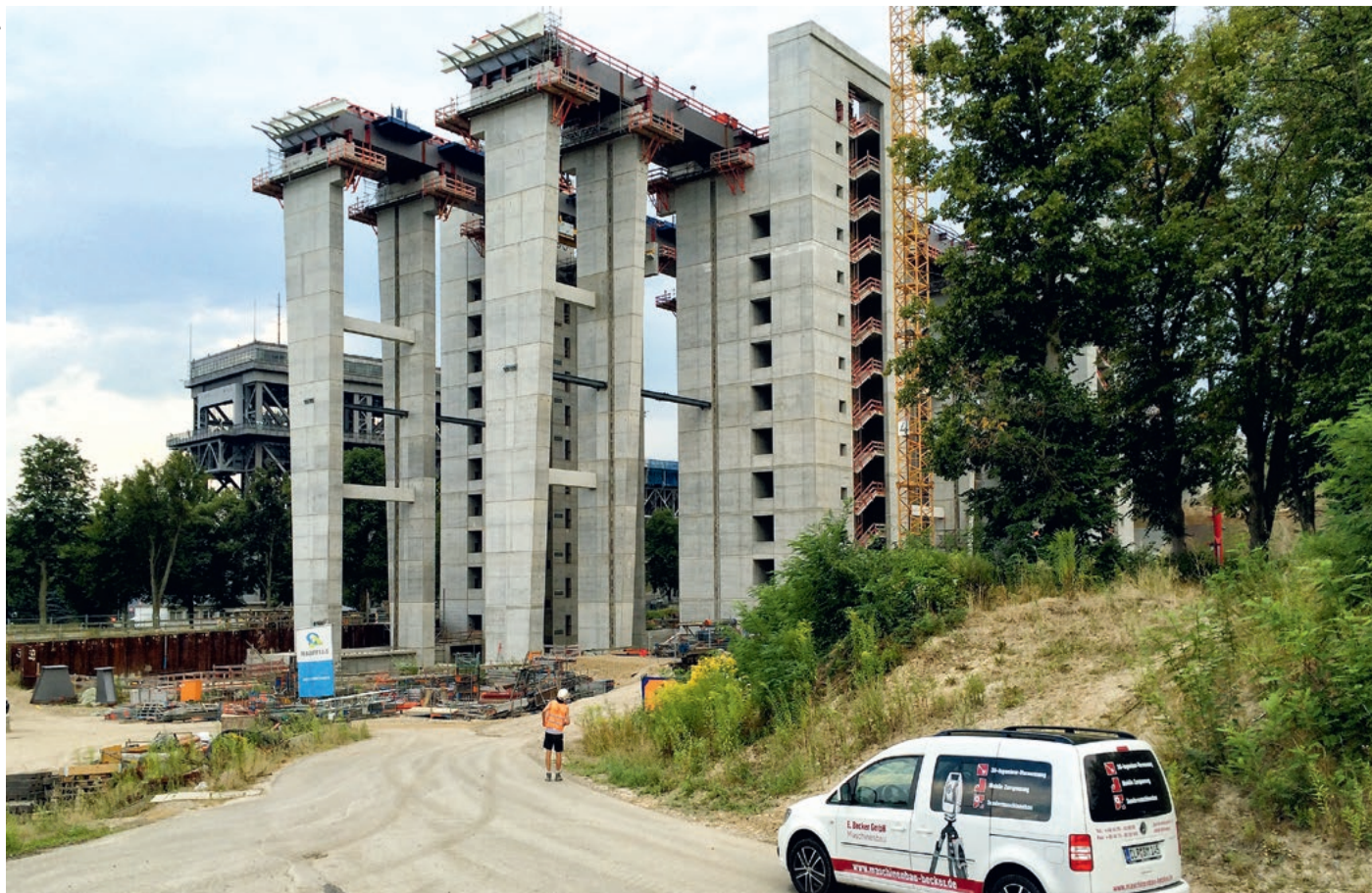
Becker im Einsatz: Vermessungsspezialist aus Molbergen beim Neubau des Schiffshebewerkes Niederfinow in Brandenburg.
